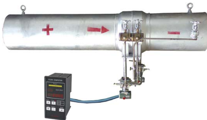
图 6 一体化差压流量计与工艺管道的连接
